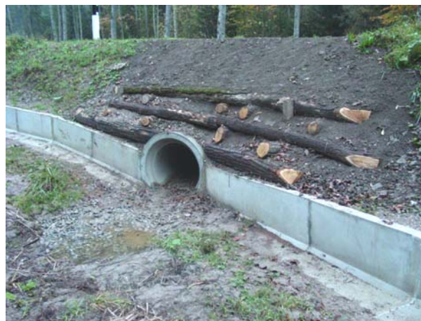
Tubes et caniveaux en L constituent le noyau du crapauduc de la Bressone
